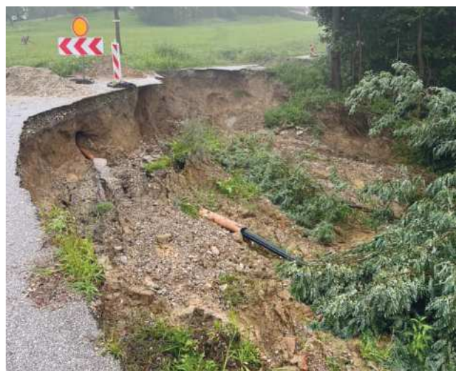
Zemeljski plaz v Oseku je odnesel cesto.
